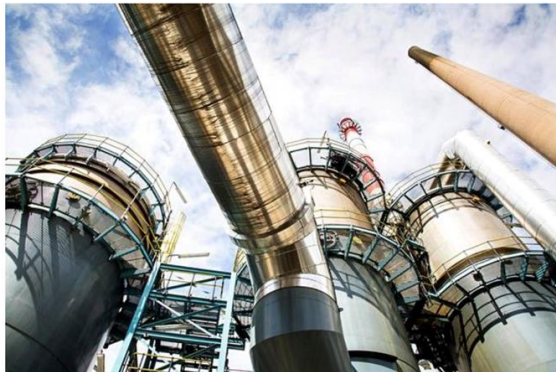
Outotecin toimittama kaasunpuhdistusjärjestelmä ja rikkihappotehdas käsittelee kuparisulaton poistokaasut rikkihappoksi Tsumebin pikkukaupungissa Namibiassa. (KUVA: TIJU KAITALO)
